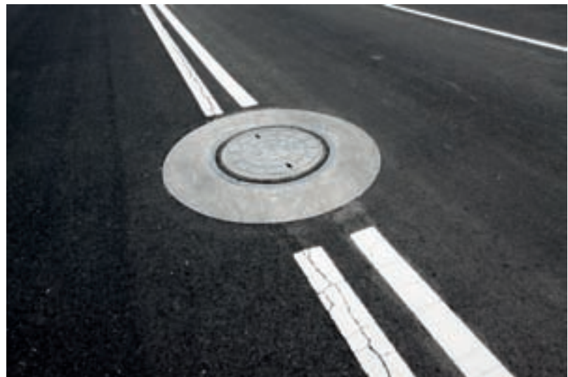
Caixa de saneamento
